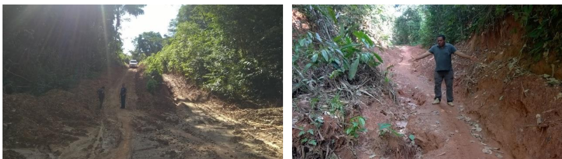
Figuras 35 e 36. Impossibilidade de tráfego no ramal Porto da Serra
